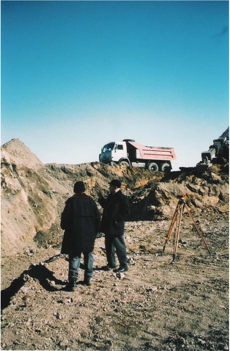
На аварийном участке дороги, 2004 г.
